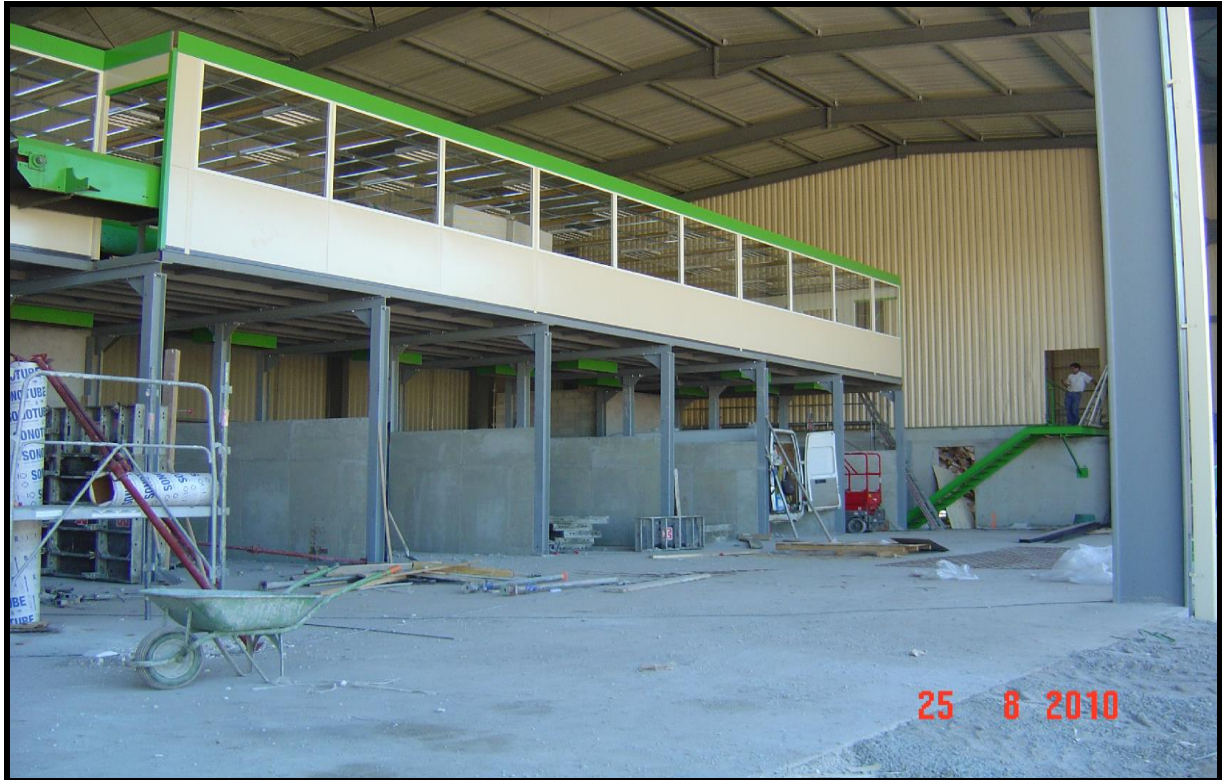
CENTRE DE TRI - V.N.I (83) – CABINE DE TRI INSONORISEE, CLIMATISEE ET CHAUFEE
